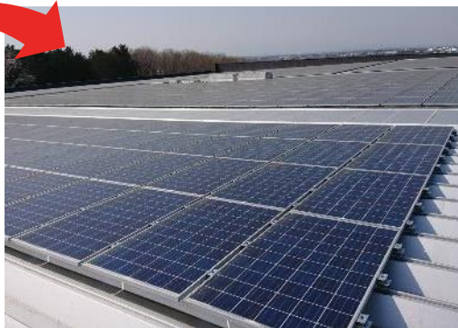
▼屋上に太陽光発電システムを設置
