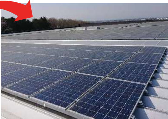
▼屋上に太陽光発電システムを設置
