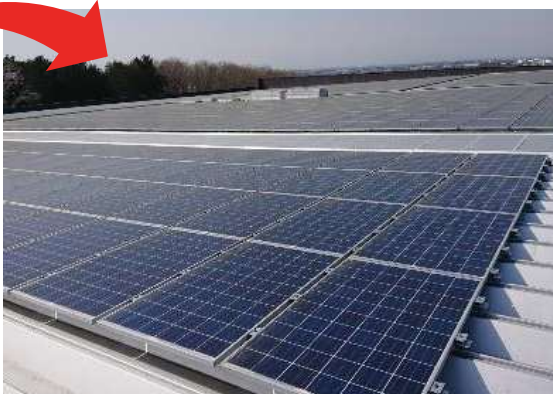
▼屋上に太陽光発電システムを設置
