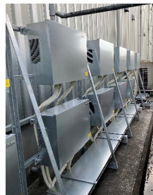
▲パワーコンディショナは計13台設置しています
